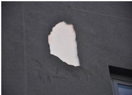
Z czasem, zwykle po sezonie zimowym, w miejscach pojawienia się pęcherzy dochodzi do odspojenia warstwy tynku / farby.
