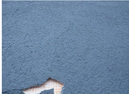
Rysy mające swoje źródło w naprężeniach termicznych prowadzą do odspojenia warstwy tynku.
