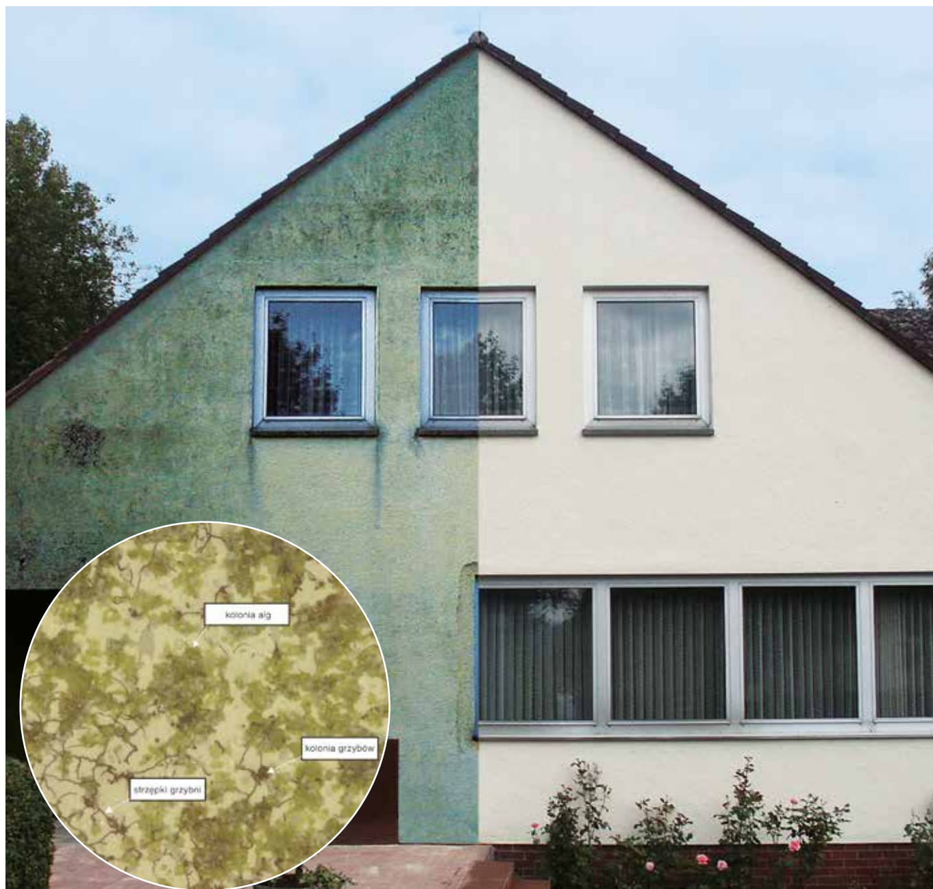
Fasada zaatakowana przez mikroorganizmy przed i po fachowej renowacji
